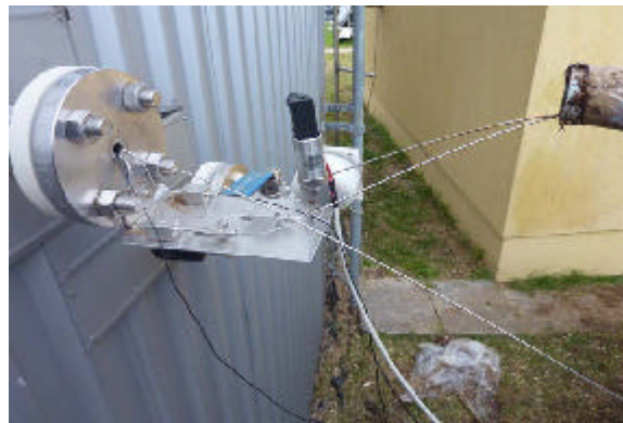
Prototyp des Wasserstoffsensors beim Einsatz in der Praxisanlage Krusemark
